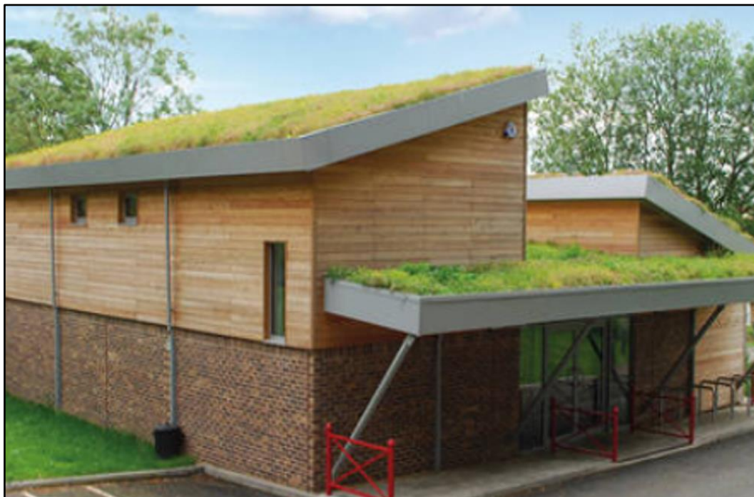
Figur 28. Sedumtak kan anläggas både på platta och lutande tak (Svenska Naturtak AB, 2018).
